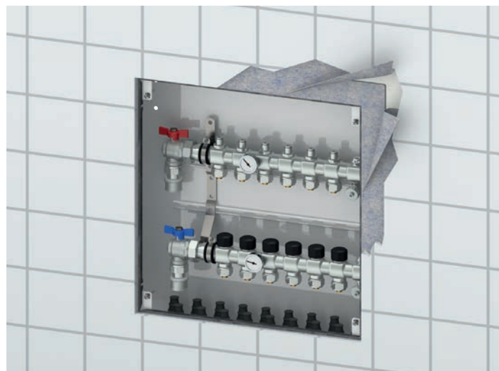
Golvvärmefördelare i våtzonsskåp
