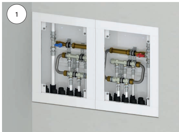
1. Här är ett exempel där två skåp, ett med kallvatten- och ett med varmvattenfördelare, har monterats samman sida vid sida.
